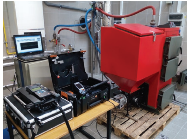
Fig. 2. View of the heating boiler with the test stand Rys. 2. Widok stanowiska badawczego
